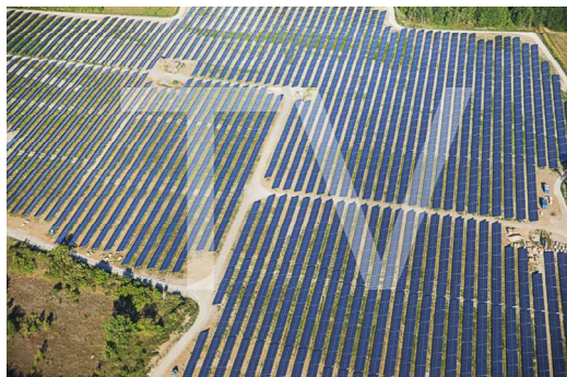
Centrale solaire photovoltaïque de Volgelsheim (5)
