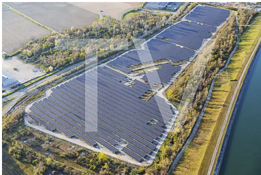
Centrale solaire Ottmarsheim (5)
