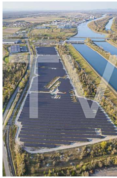
Centrale solaire Ottmarsheim (15)
