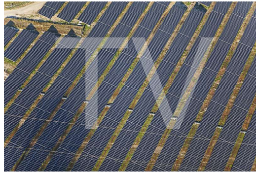
Centrale solaire Ottmarsheim (30)
